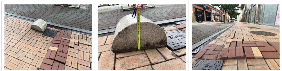
25cm 높이의 석재 반원볼라드, 보도블록의 돌출로 평탄하지 않는 바닥
